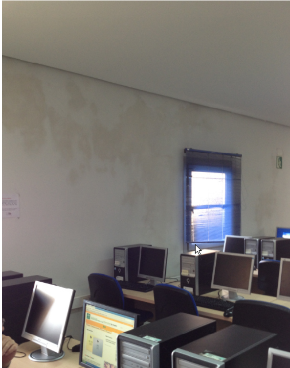
Humedades sobre pintura de paramento
