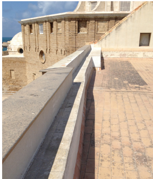
Falta de chapa de albardilla
