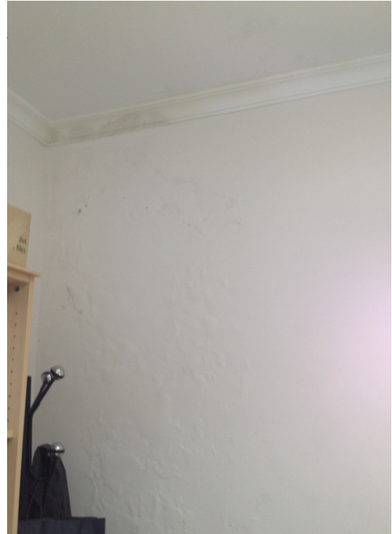
Pompas en pintura
