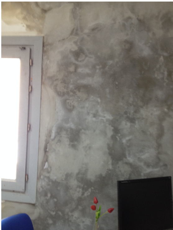
Eflorescencias sobre tratamiento de enfoscado
